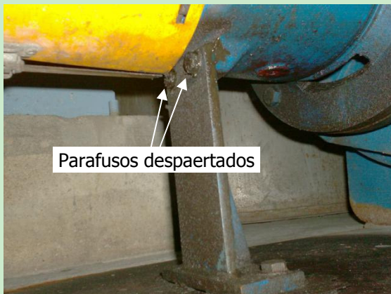
Figura 8 – Fotografia identificando os parafusos que se encontravam desapertados
