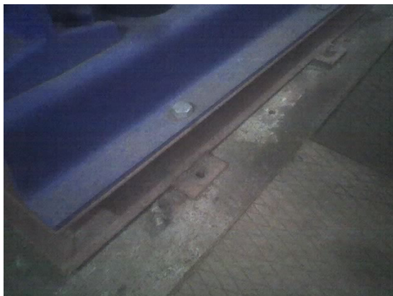
Figura 2 – Fotografia da base evidenciando a falta de parafusos de fixação da base, ao maciço.
